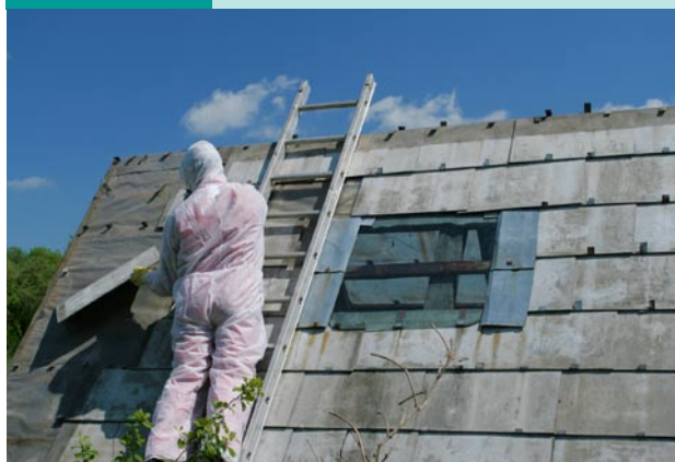
AMIANTE – TRAVAILLEUR SUR UN TOIT
